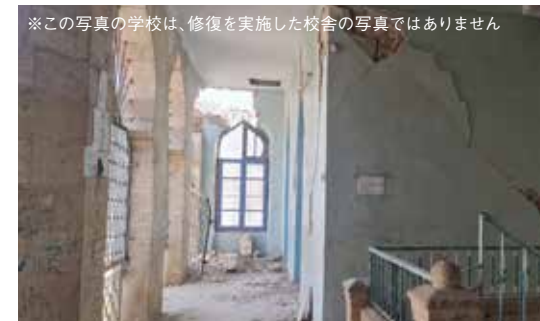
※この写真の学校は、修復を実施した校舎の写真ではありません。 シリア北西部では50%を超える学校が影響を受けました。
