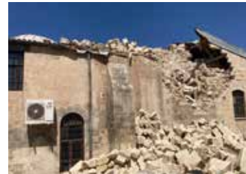
ガズリアンテップでは、未だに地震の被害が残る箇所が多くみられました。
